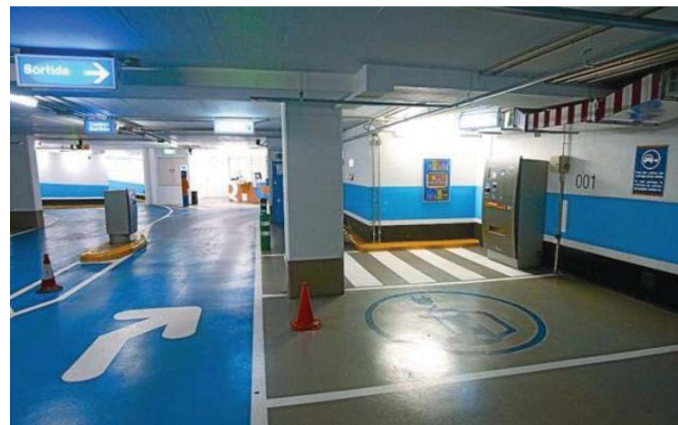
Plaça per a la recàrrega de vehicles elèctrics en aparcament soterrani.
